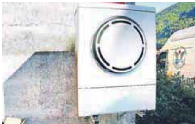
Zunanja enota toplotne črpalke je nameščena na zunanji steni bloka in deluje skoraj neslišno.
